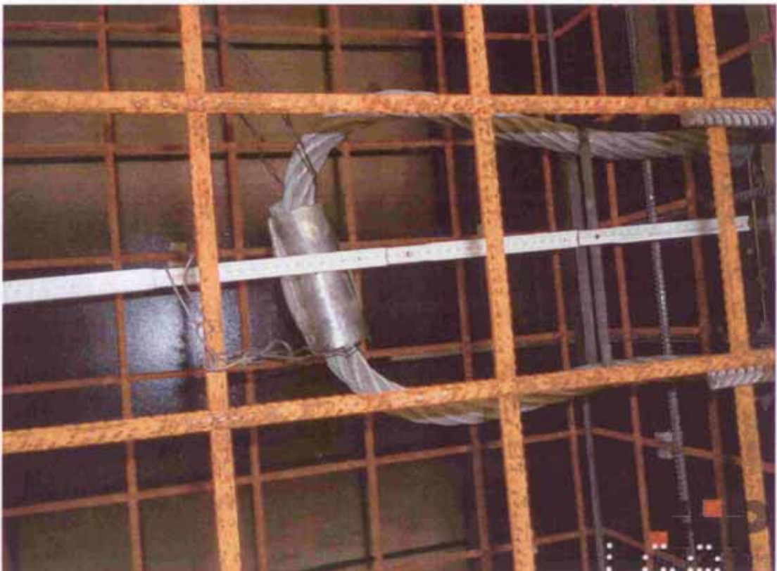
Bild 78 Betonschlaufenanker: Einbindetiefe 51cm, Überstand 18cm
