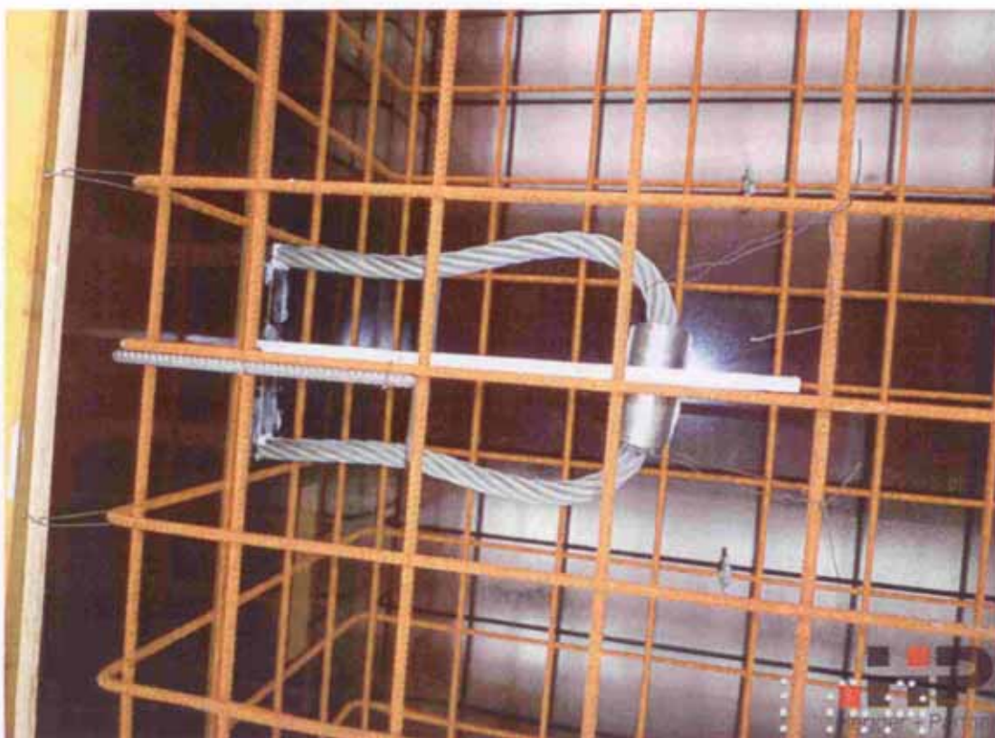
Bild 74 Detailaufnahme des Ankers mit Auswechsel-Bewehrungsstab. Einbindetiefe: 51cm
