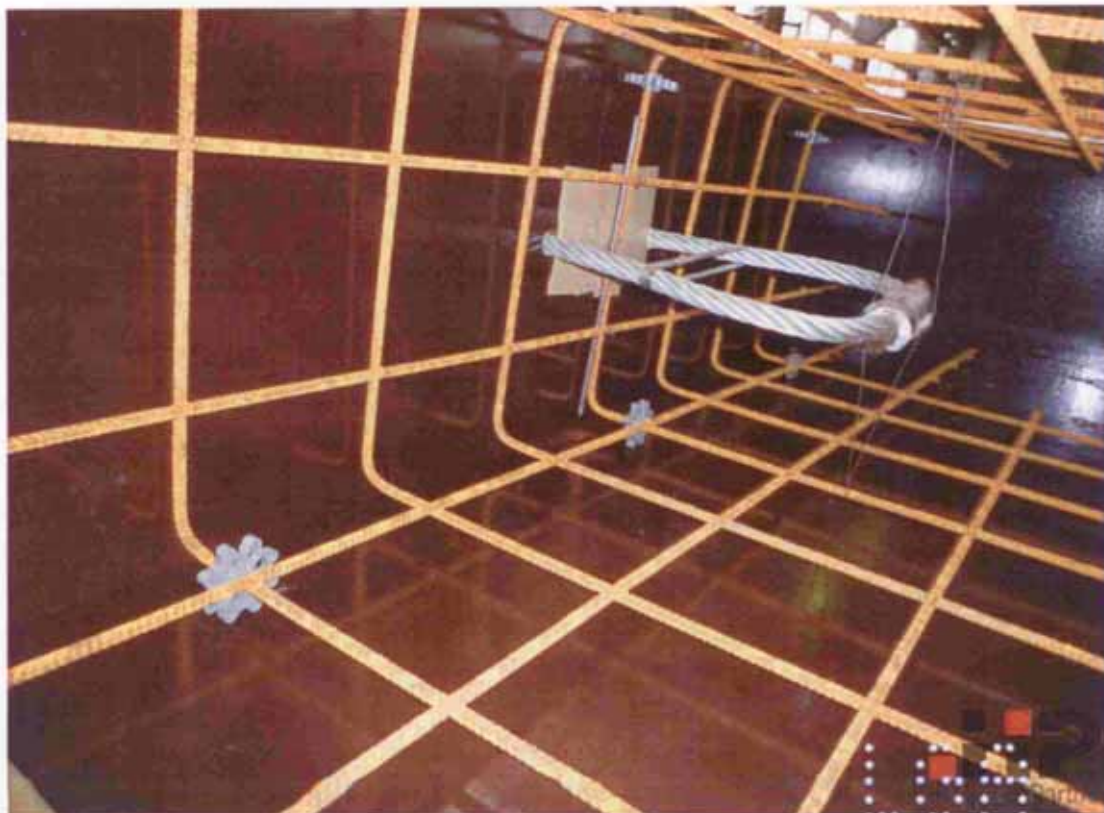
Bild 26 Innenaufnahme mit Auswechsel-Bewehrungsstab (Ausführung zu kurz und ohne Haken)
