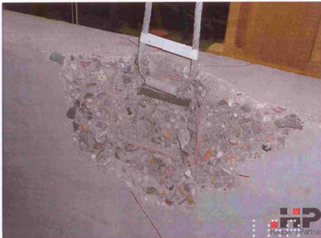
Bild 4 Betonausbruch und Herausziehen des Ankers
