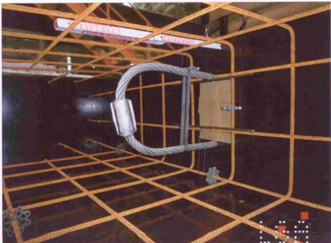
Bild 36 Innenaufnahme mit Auswechsel-Bewehrungsstäben (Übergreifungslänge zu kurz)
